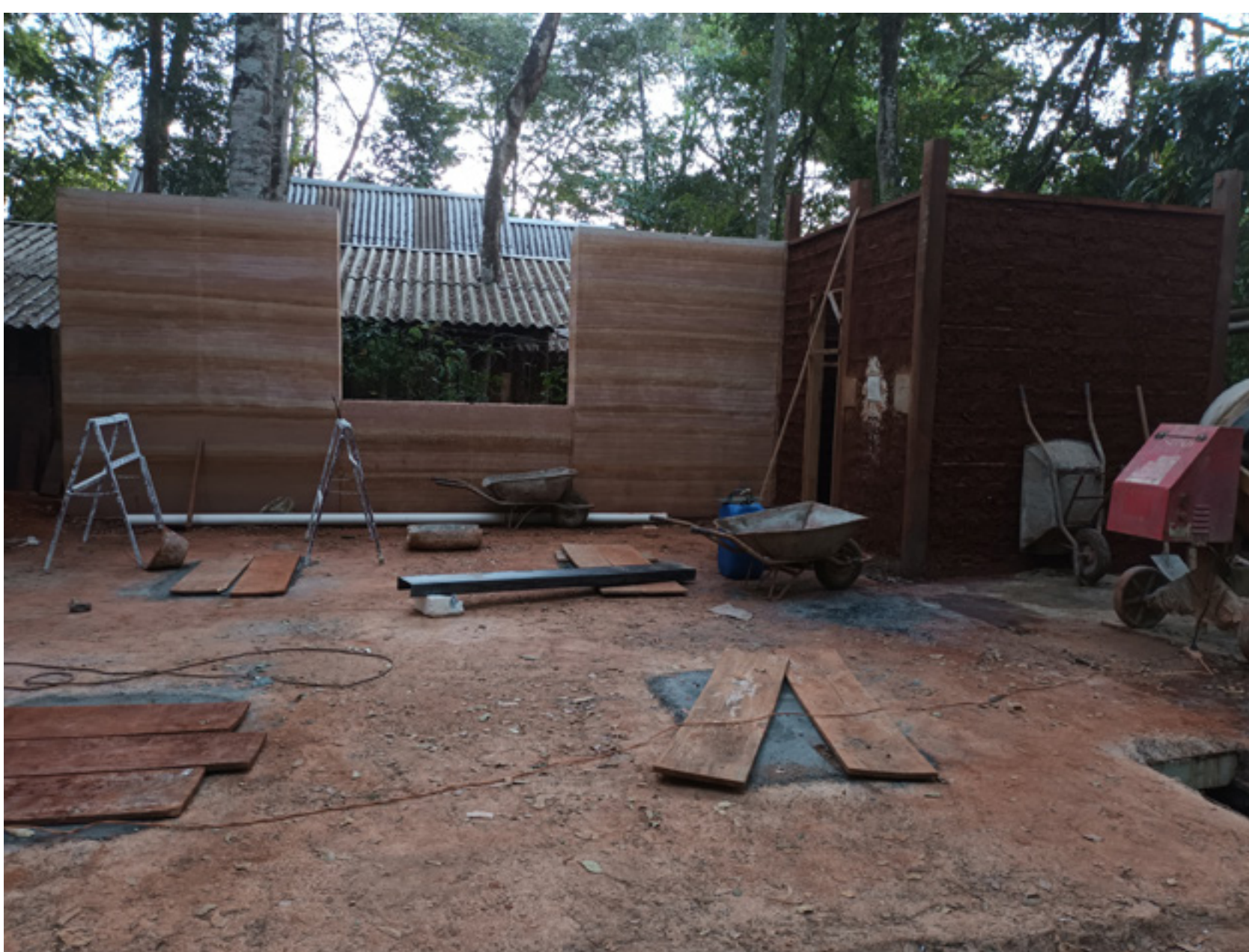
Figura 3. Obras de nova cozinha do Sertão Negro, de Dalton Paula, com parede em técnica construtiva de taipa de pilão. “Parede com baixa emissão de carbono, respira, então não tem mofo no ambiente”. E a construção ao lado de bambu a pique. Jun. 2023. Acervo pessoal.
